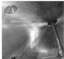
Obr.2 Pohľad do vnútra procesného tanku: hore vľavo je procesné pripojenie s hygienickým radarovým senzorom, vpravo je hlava na čistenie CIP, vľavo dole upevňovací otvor
